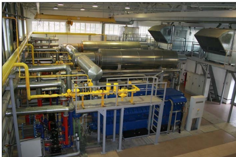
Энергоустановка обеспечивает теплом и горячей водой жилые микрорайоны.
